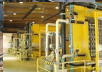
Končna postavitev in cevovodne povezave
