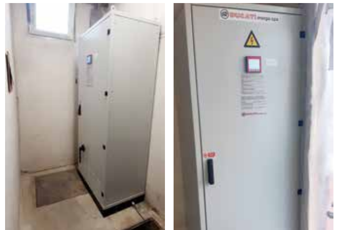
V obratu Praškastih lakov in Transformatorski postaji 1.
