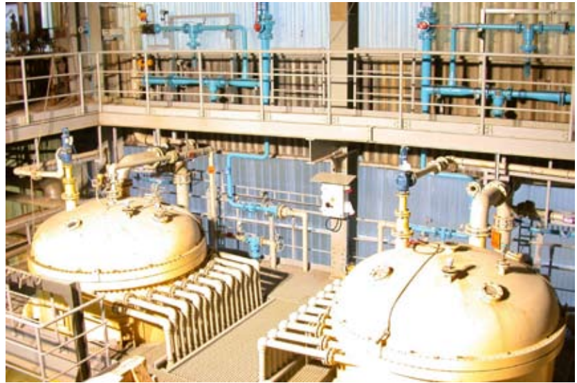
Postavitev filtrov Fundaba
