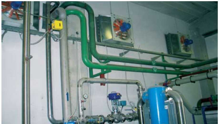
Izvedba prisilnega prezračevanja z aksialnimi ventilatorji v kompresorskih postajah PE TiO 2 , PE Metalurgija in PE VčE.
